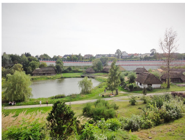
Fot. 3. Widok ze skarpy doliny Czechówki w Lublinie (Muzeum Wsi Lubelskiej) w kierunku budowanego przedłużenia Alei Solidarności. Fot. S. Bernat
